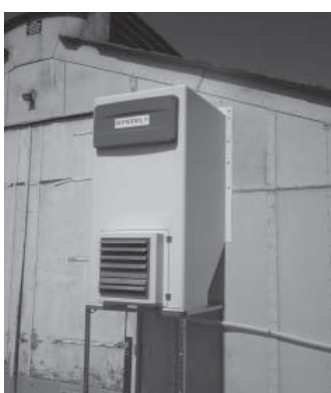
Echangeur de chaleur installé en pignon de bâtiment (Orne).
