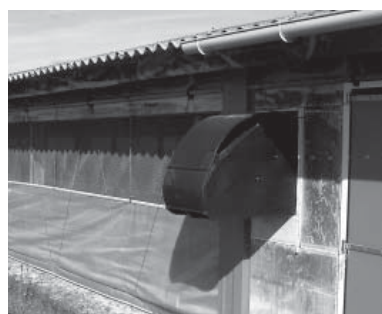
Echangeur de chaleur installé sur un poulailler "Louisiane" (Ille-et-Vilaine).
